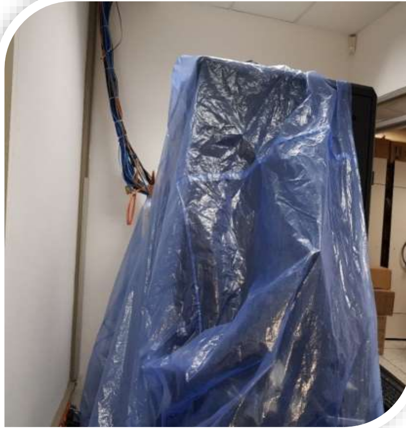
PROTECCION DE AGUA INADECUADO
