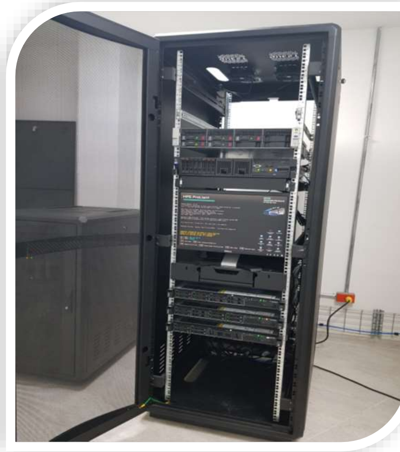
GABINETES QUE PROTEGEN SERVIDORES
