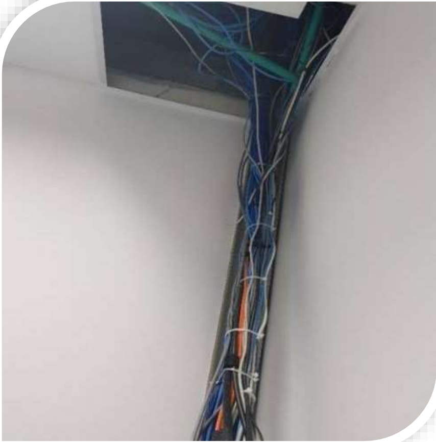
CIELO RASO INADECUADO (CARTON)
