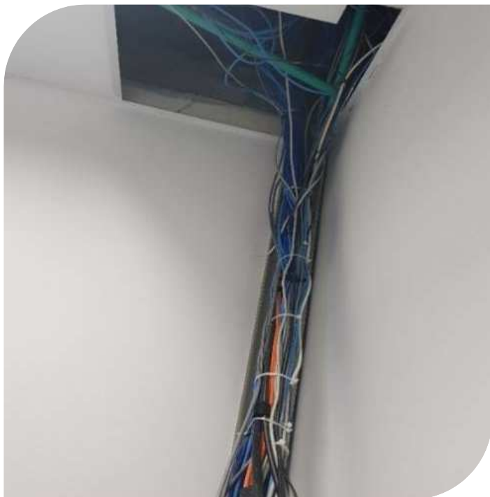
CIELO RASO INADECUADO (CARTON)
