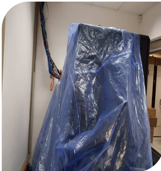
PROTECCION DE AGUA INADECUADO
